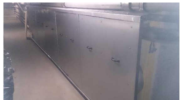
Neuer Wärmetauscher mit Abdeckung, am 12.01.2016
