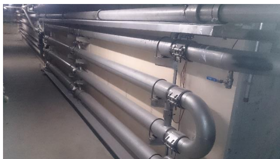
Neuer Wärmetauscher ohne Abdeckung (Isolation), 26.10.2015
