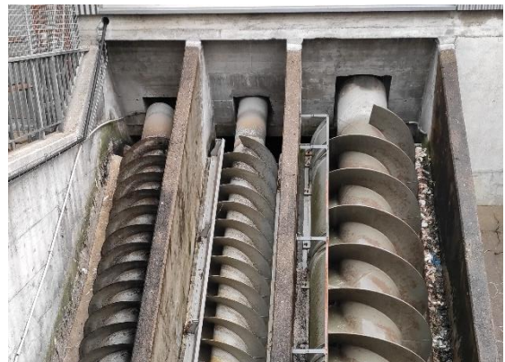
Rohabwasser Schneckenpumpwerk am 12.04.2021
