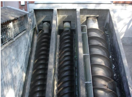
Rohabwasser Schneckenpumpwerk am 12.10.2005
