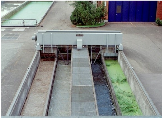
Sand- und Fettfangbecken 1 und 2 am 14.04.2005
