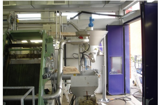
Rechenraum mit Sandwaschanlage kurz vor der Inbetriebsetzung am 26.10.2009
