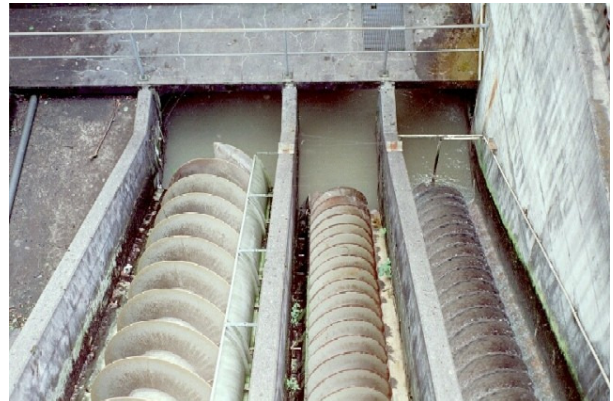
Rohabwasser Schneckenpumpwerk Blick von oben am 14.04.2005
