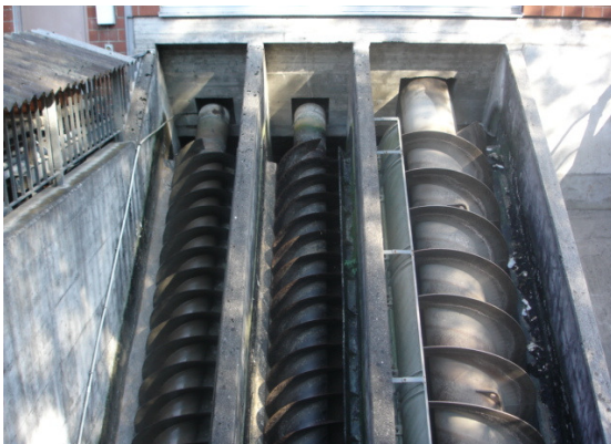
Rohabwasser Schneckenpumpwerk Blick von unten am 12.10.2005
