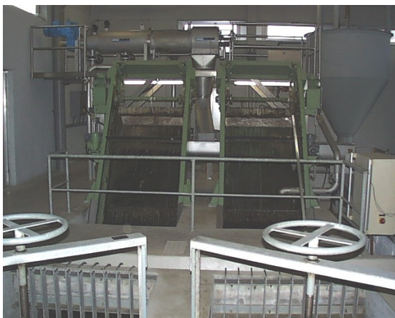
Rechenanlage Strainpress und Sandentnahme am 06.01.2004
