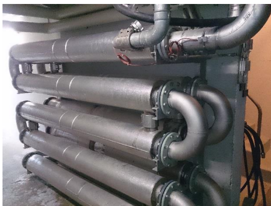
Ansicht Wärmetauscher, noch mit hintereinander angeordneten Rohren am 02.05.2014
