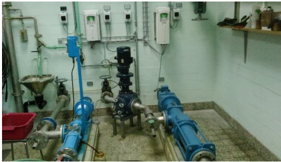
Zuführschlammumpen zur FSE
