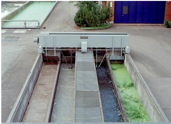
Sand- und Fettfangbecken 1 und 2 am 14.04.2005
