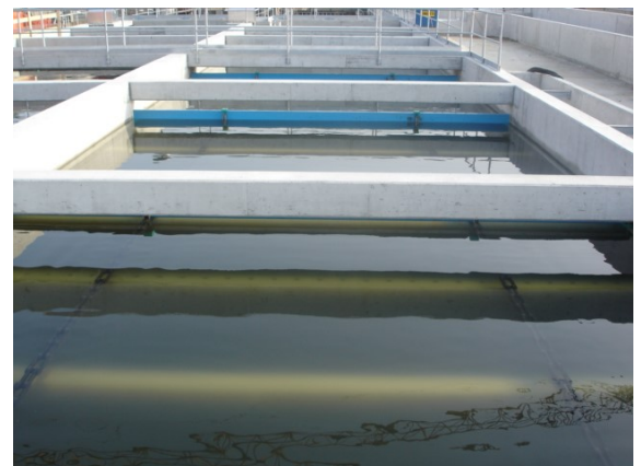
Nachklärbecken in Betrieb Aufnahme am 17.03.2006
