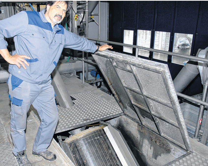
ARA-Betriebsleiter Noldi Kistler zeigt eine Siebtrommel, wo alles grobe Material abgeschieden wird.
