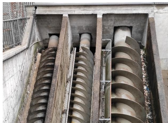
Rohabwasser Schneckenpumpwerk am 12.04.2021
