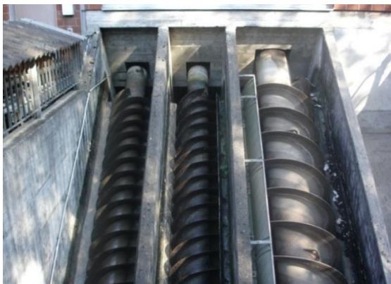
Rohabwasser Schneckenpumpwerk am 12.10.2005
