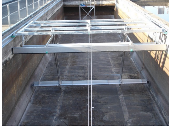
Neuer Schleppräumer, Betrieb ab 2012 Vorklärbecken 2 leer, während Rückfahrt Aufnahme am 15.03.2012
