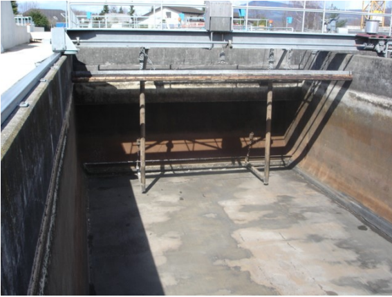
Alter Brückenräumer, Betrieb 1973-2012 Vorklärbecken 2 leer, Räumer in Startstellung Aufnahme am 03.04.2006
